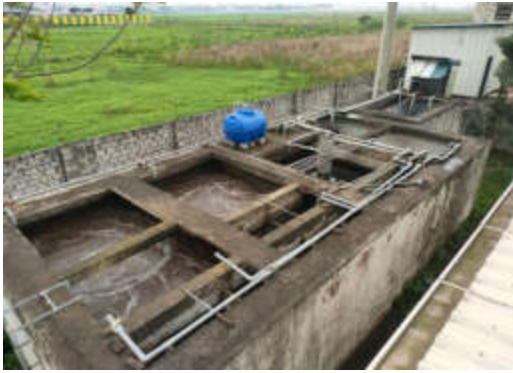
Hệ thống xử lý nước thải tập trung của nhà máy
