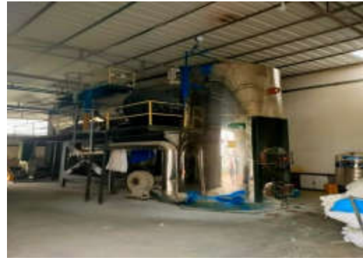
Lò hơi và hệ thống xử lý khí thải lò hơi
