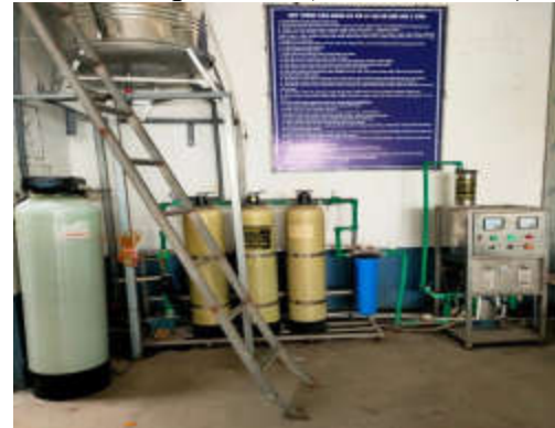
Hệ thống lọc nước uống
